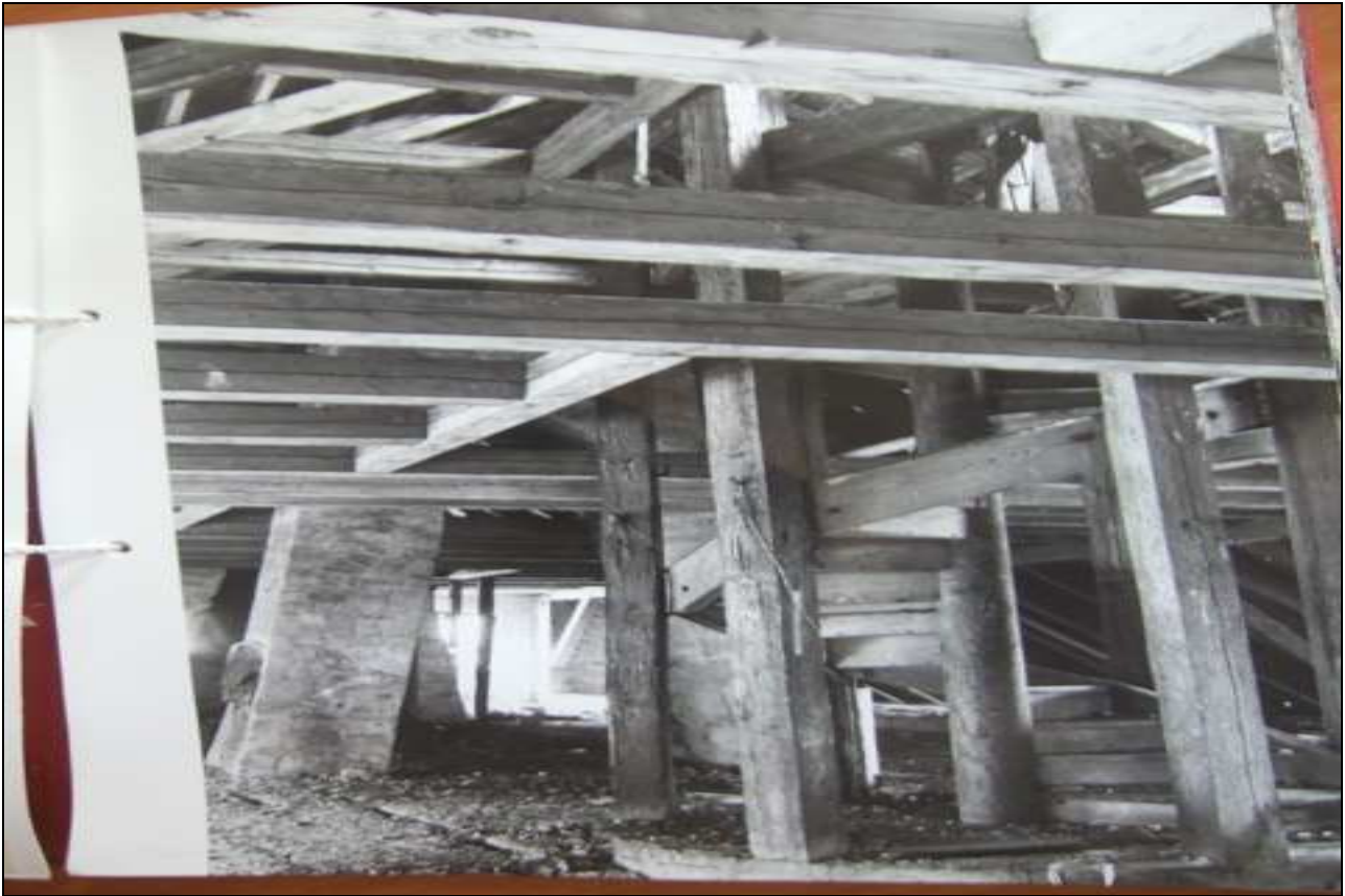
Konstrukcja strychu i więźby dachowej – w głębi widać ciekawy komin tzw. portkowy.
